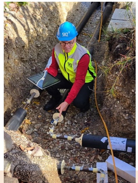
Robert Schmitt, Geschäftsführer der Zertifizierung am SKZ, in einem Baugraben bei der Kontrolle einer Fernwärmeleitung (Foto: SKZ)
